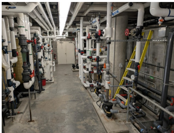
Usine de traitement d'eau (AQC1 et AQC2).
